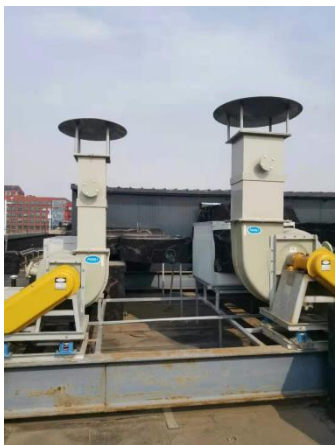
活性炭吸附装置+排气筒
