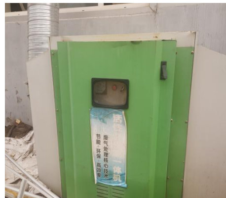
废气治理设施
