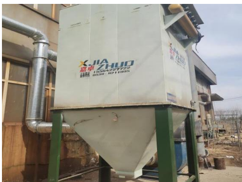
废气治理设施
