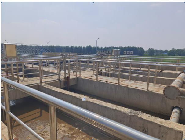
A 2 /O 生化池
