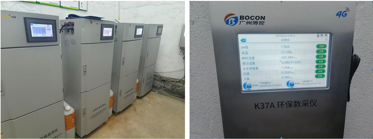
图 5-5 昌图经济开发区污水处理厂尾水在线监测设备
