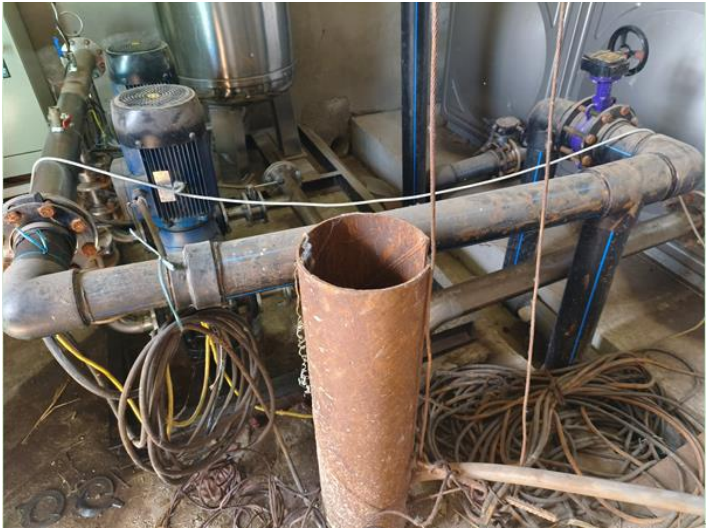
图 5-8 水泵房内的地下水监测采样口（即污染监控井）
