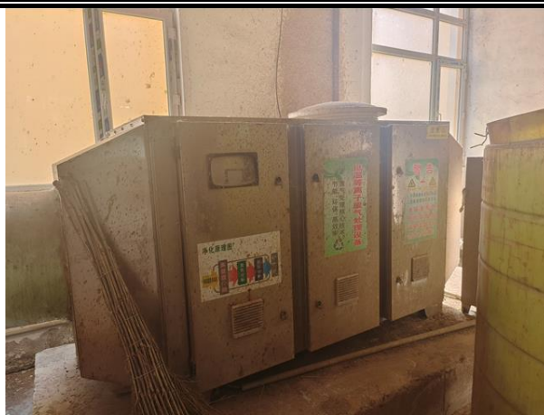
污泥处理区臭气处理设备
