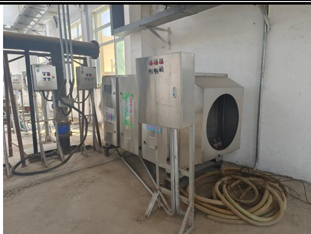
预处理车间臭气处理设备
