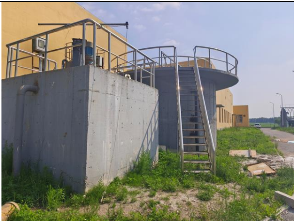
污泥浓缩池及调质池
